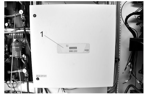
1 Störungsanzeige im Display der Steuerung
